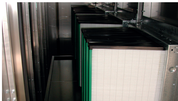
04 . Dettaglio sezione di prefiltrazione G4+F9 04 . Detail G4+F9 pre-filter section
