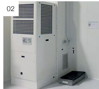
02. Unità di trattamento aria MAE 02. MAE conditioning unit
