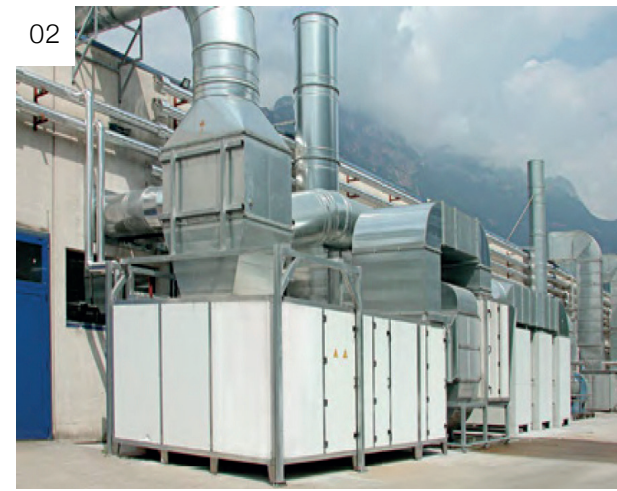
02. Gruppo UTA-CHILLER-RECUPERO CALORE 02. UTA-CHILLER-HEAT RECOVERY
