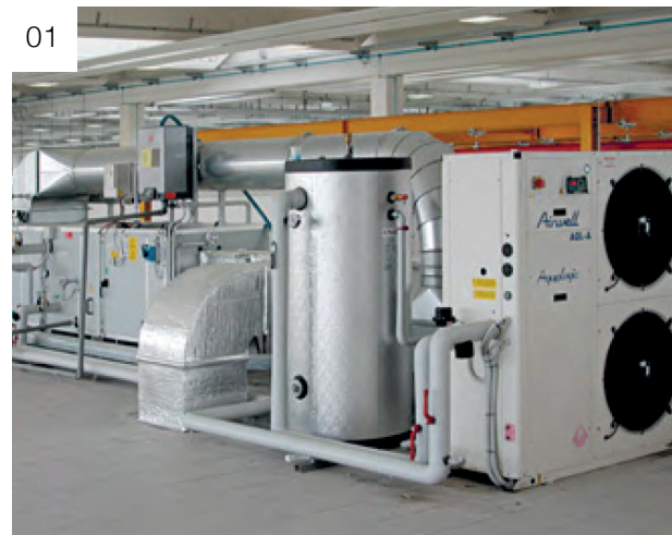
01. Gruppo UTA-CHILLER 01. UTA-CHILLER group
