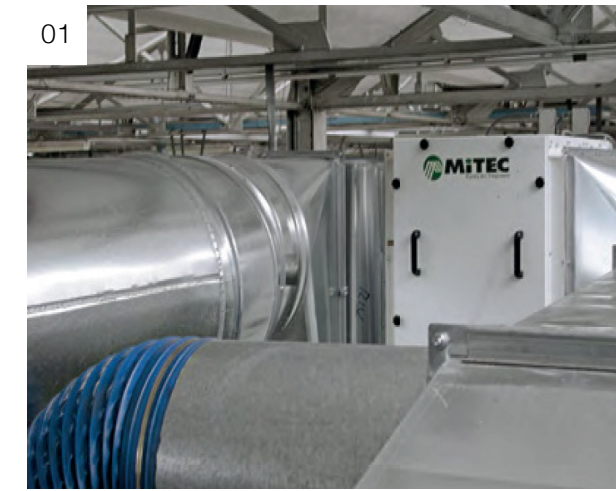
03. Stazione di filtrazione in linea MCF 03. In line filtering station MCF
